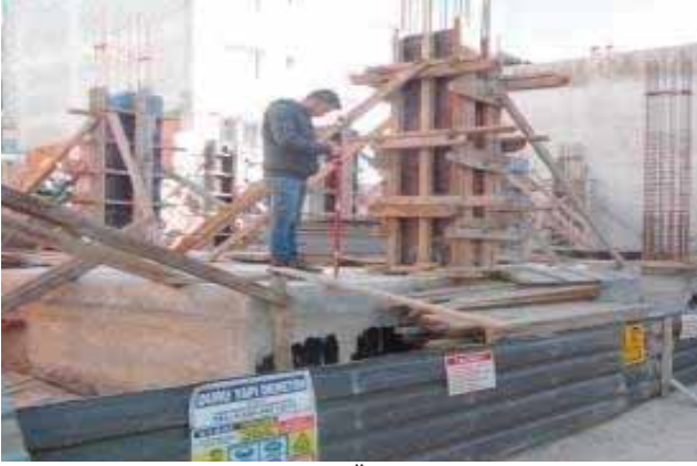
SU BASMAN KOTU KONTROLÜ
